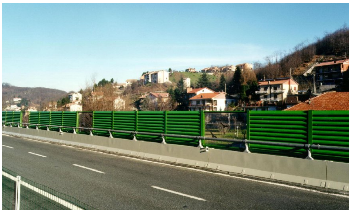
Figura e. Barriera in laminato metallico.
